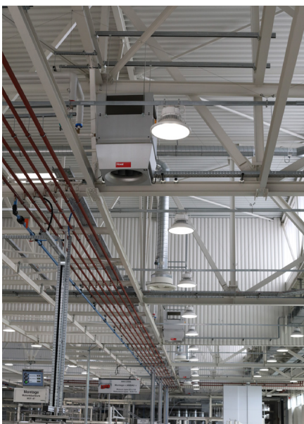
Die dezentralen Umluftgeräte ohne Lüftungskanäle lassen sich in die Halleninfrastruktur integrieren, ohne zu einem Hindernis für die übrigen Systeme zu werden (Regale, Kranbahnen, Beleuchtung, etc.).
