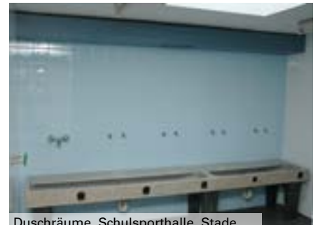
Duschräume, Schulsporthalle, Stade
